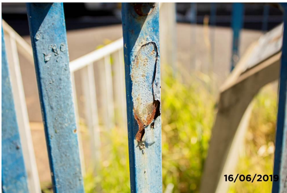
Foto 16: Detalhe da corrosão no guarda corpo.
