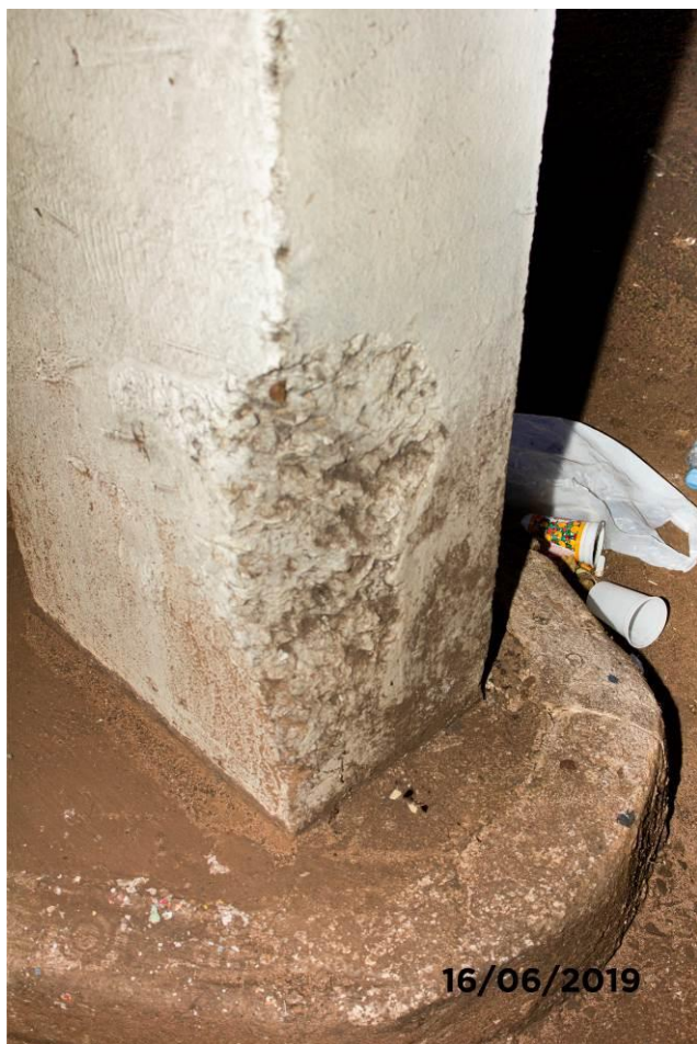
Foto 36: Deslocamento de concreto no pé do pilar.
