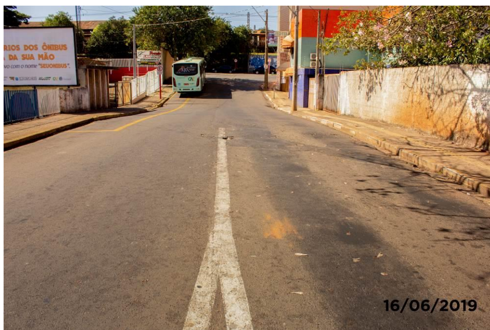
Foto 04: Vista da junta de dilatação no encontro.
