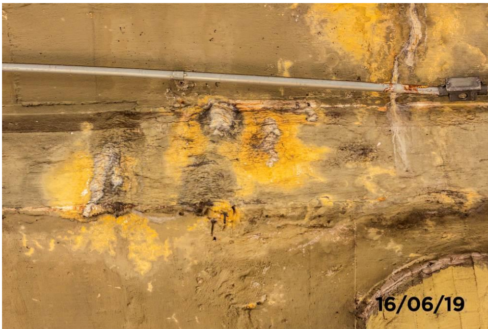
Foto 32: Detalhe de eflorescência.
