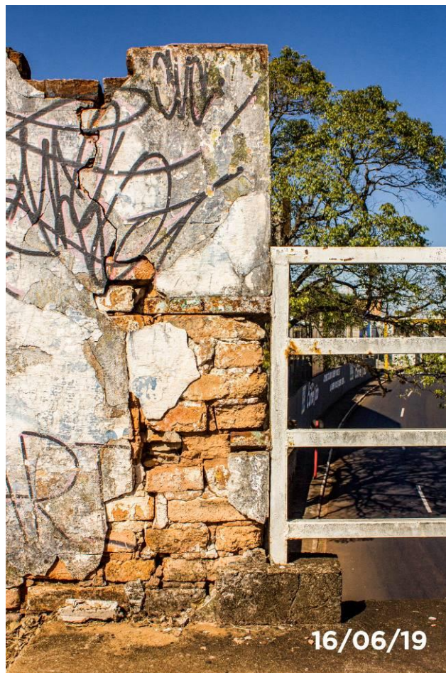
Foto 16: Detalhe do guarda corpo com corrosão.
