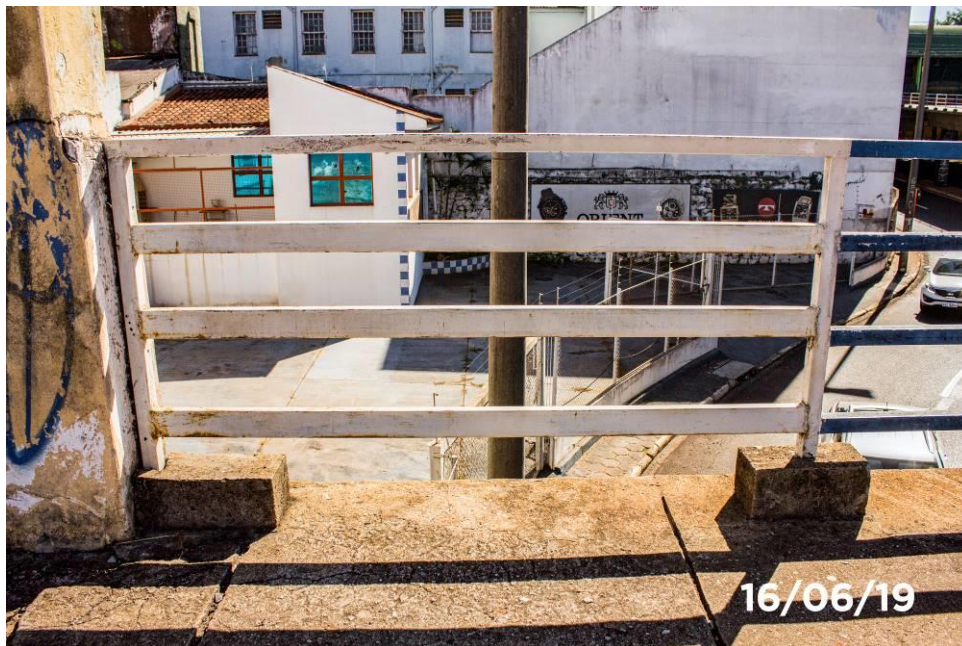
Foto 17: Detalhe guarda corpo com corrosão.
