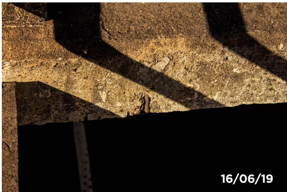
Foto 18: Detalhe armadura exposta laje do tabuleiro.
