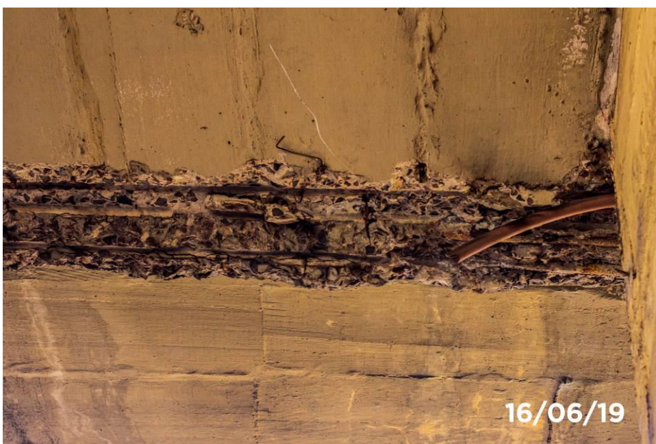
Foto 33: Detalhe de dutos rompidos.
