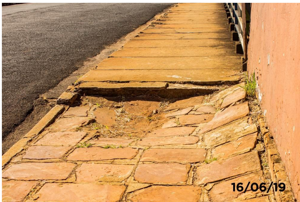
Foto 08: Detalhe da depressão no acesso ao passeio.
