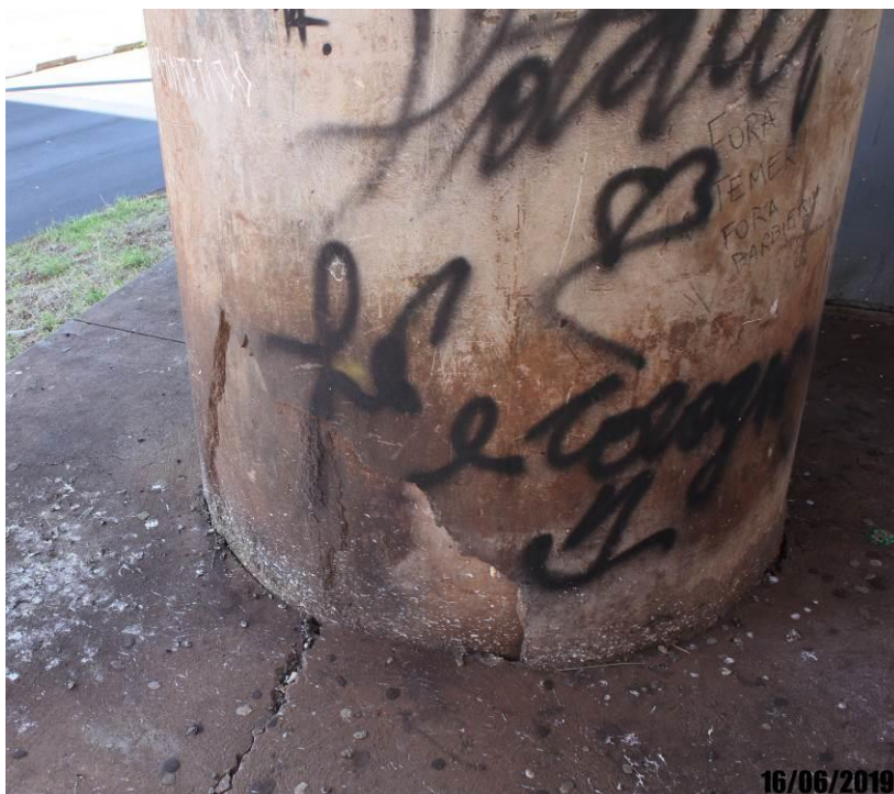
Foto 58: Detalhe de deslocamento de concreto.
