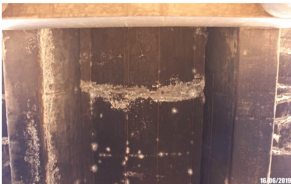
Foto 41: Detalhe de fissura e fuligem.
