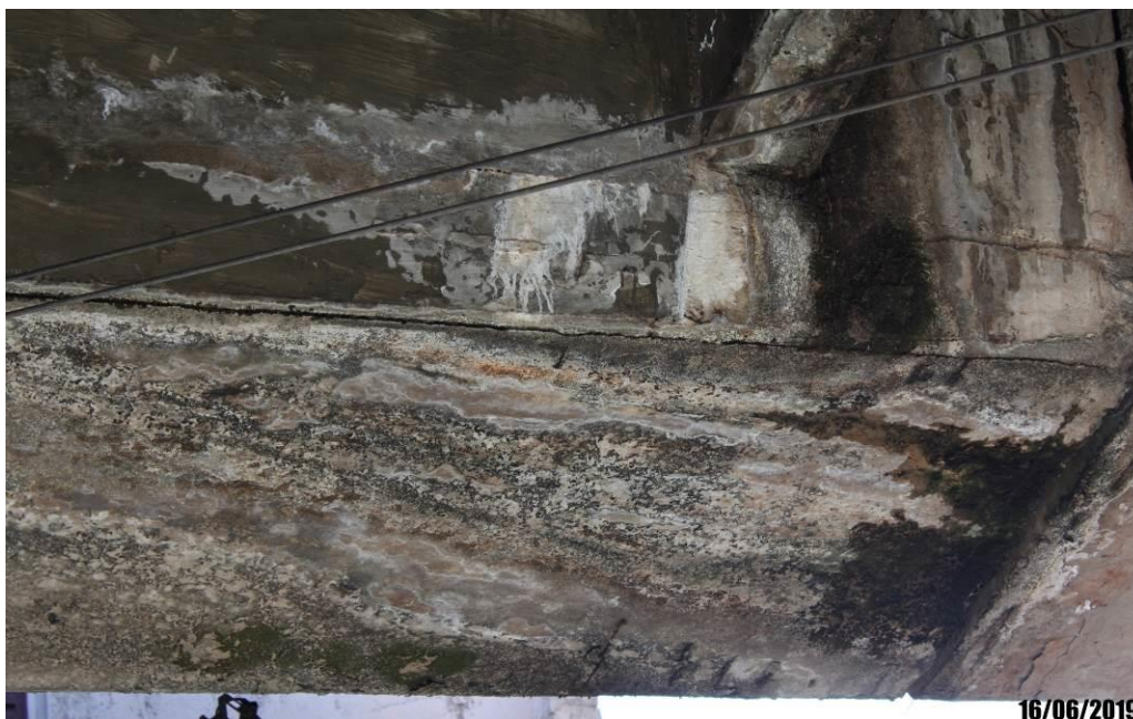
Foto 51: Detalhe de eflorescência e deslocamento de concreto.
