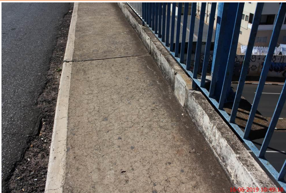
Foto 14: Detalhe das fissuras no passeio.
