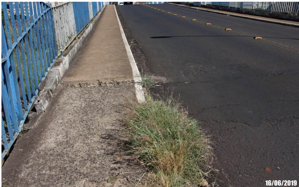
Foto 20: Detalhe da pintura do guarda corpo descolando.
