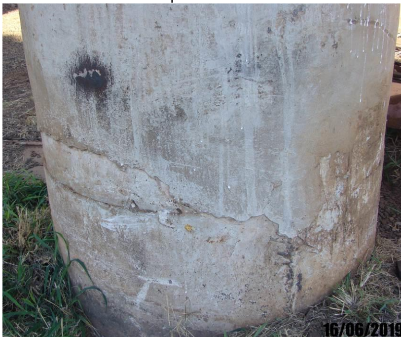
Foto 59: Detalhe de deslocamento de concreto.
