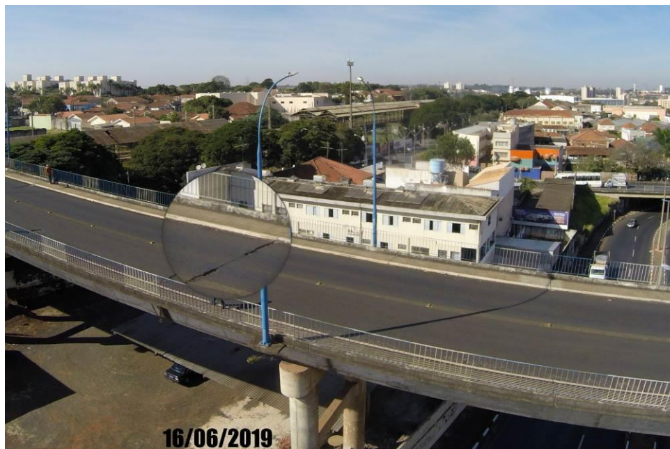
Foto 06: Vista da junta de dilatação deteriorada.
