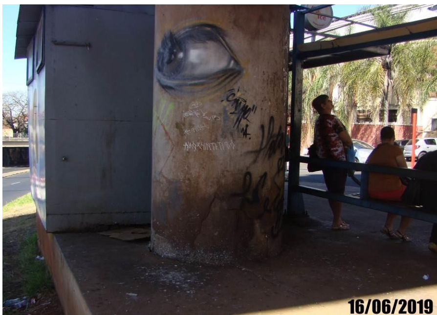
Foto 61: Detalhe de deslocamento de concreto.
