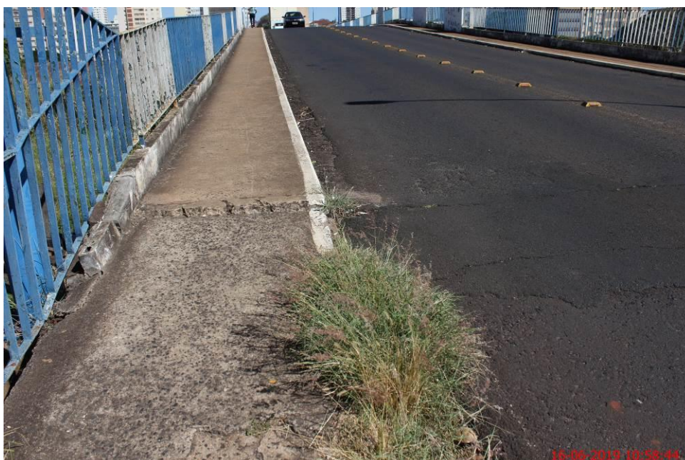
Foto 15: Detalhe do acesso ao passeio contendo desnível.
