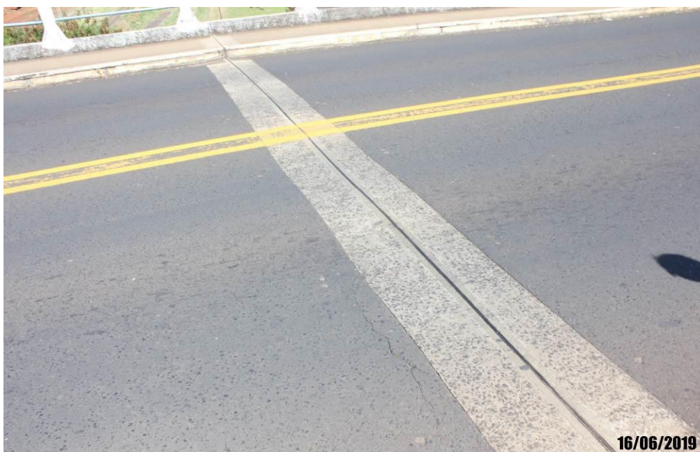
Foto 06: Face superior do tabuleiro apresentando fissuras.
