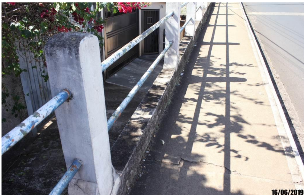
Foto 14: Detalhe da pintura do guarda corpo descascado.
