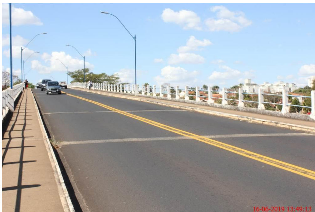
Foto 28: Vista de iluminação sobre o tabuleiro.
