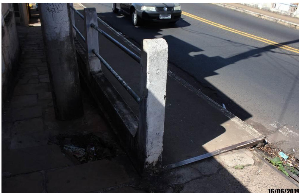
Foto 20: Detalhe do desnível no avesso ao passeio.
