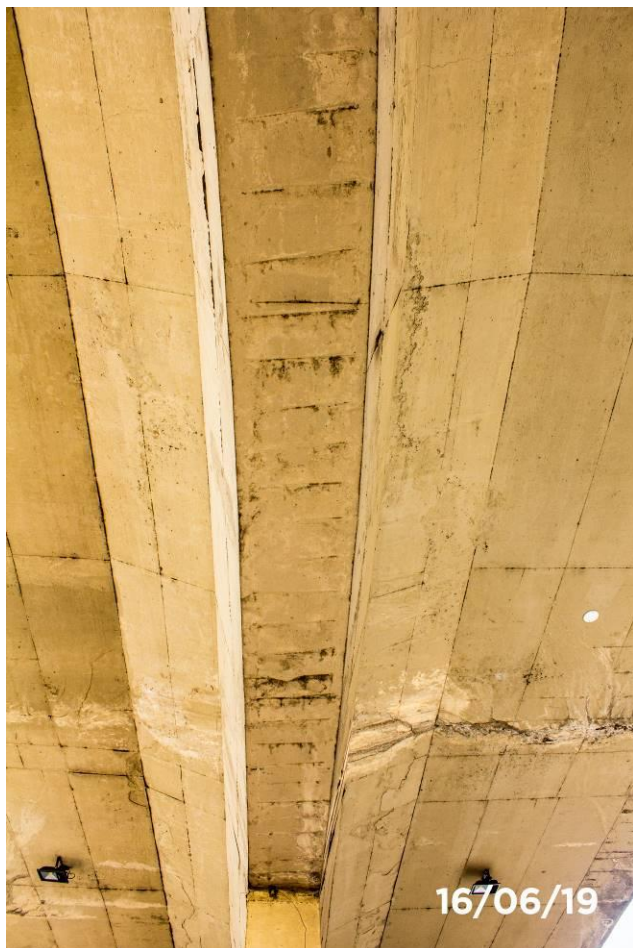
Foto 30 - Detalhe de eflorescência e armadura exposta.
