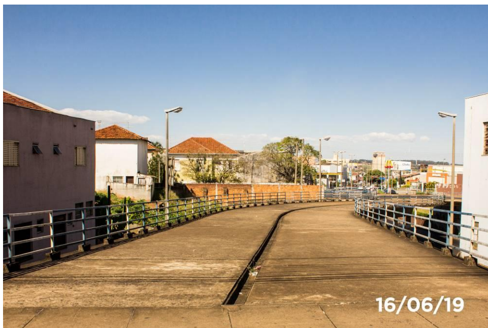
Foto 12- Vista do piso de concreto deteriorado.
