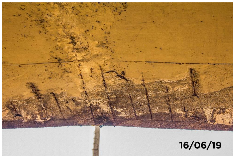
Foto 33- Detalhe de florescência e armadura exposta.
