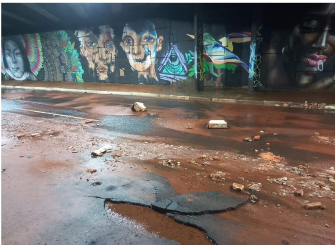
Figura 21. Vista do mesmo local sob o terminal de ônibus urbano, após findada uma chuva intensa, com a destruição do pavimento e carreamento de materiais sólidos de grandes dimensões que colocam em risco a população.
