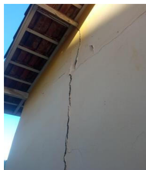
Fissura de cisalhamento
