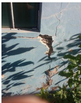
Fissura de cisalhamento
