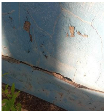
Fissura de cisalhamento em fundações e deslocamento
