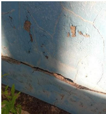
Fissura de cisalhamento em fundações e deslocamento
