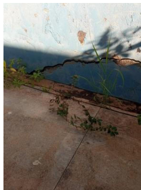
Fissura de cisalhamento em fundações e deslocamento
