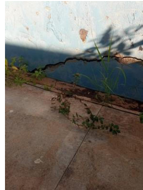
Fissura de cisalhamento em fundações e deslocamento
