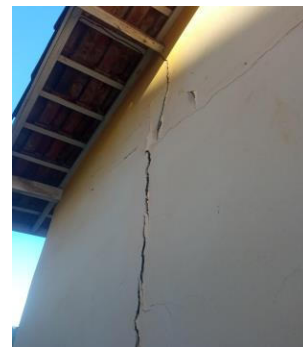
Fissura de cisalhamento
