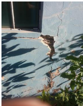
Fissura de cisalhamento
