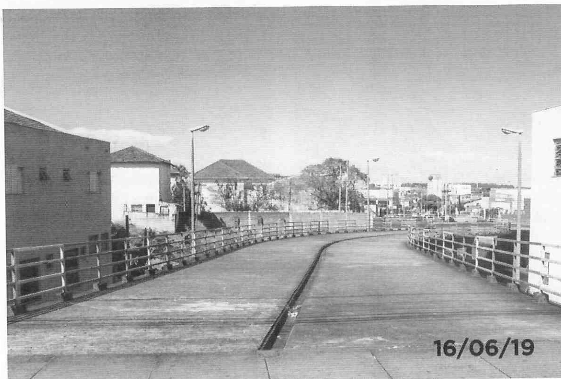
Foto 01- Vista geral do Tabuleiro da Passarela com guarda corpo metálica nas laterais.
