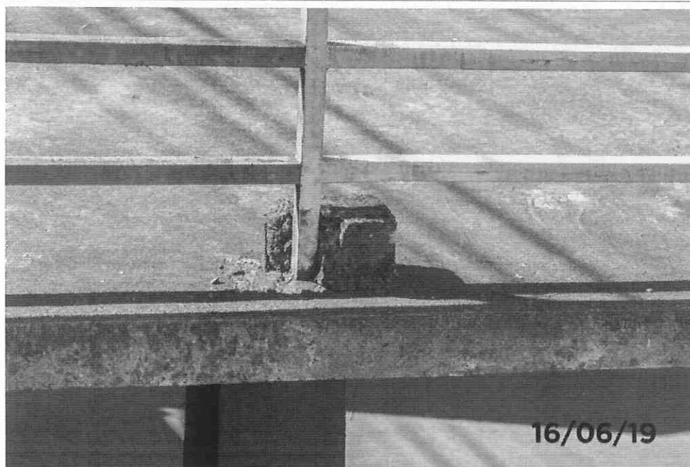
Foto 04- Ponto de fixação da guarda corpo Danificado.
