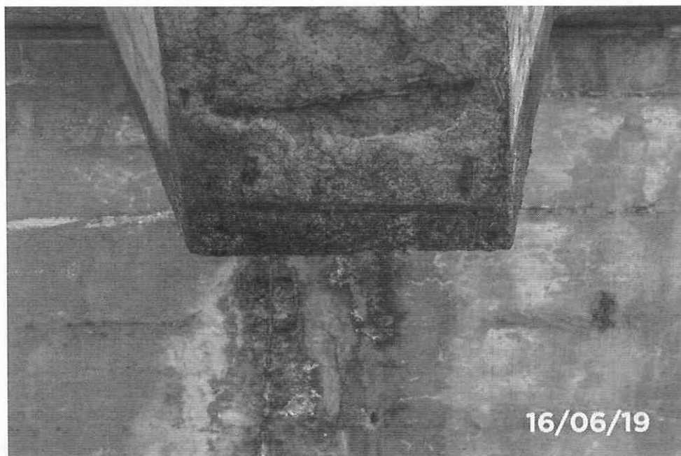
Foto 32- Detalhe de eflorescência e armadura exposta.
