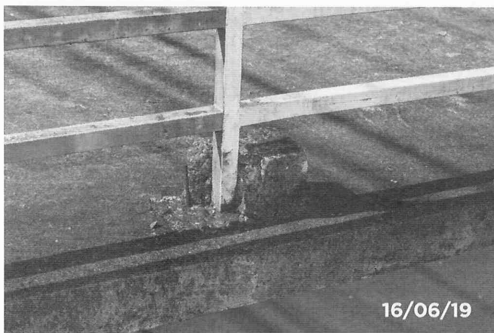
Foto 05- Armadura exposta e corrosão do ponto de fixação do G.C.
