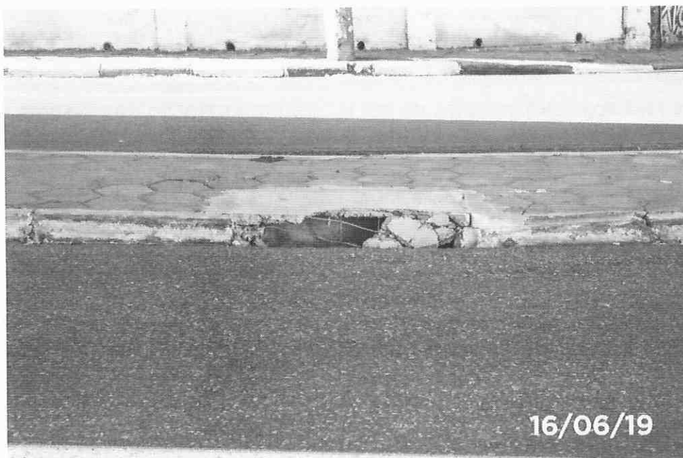
Foto 48- Detalhe boca de lobo danificada e obstruída.
