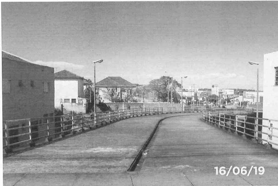
Foto 12- Vista do piso de concreto deteriorado.
