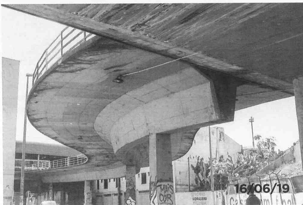
Foto 13- Vista da iluminação, infiltração, deslocamento e fissuras da parte inferior da passarela no encontro com Av. Brasil.
