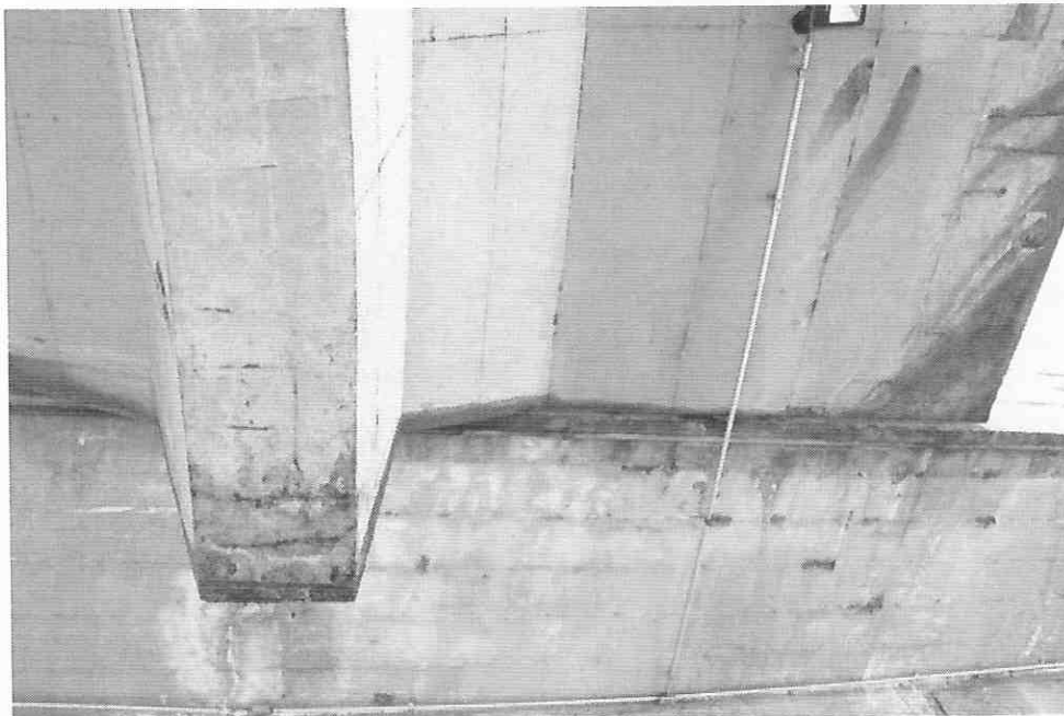
Foto 19- Vista da face inferior do encontro entre a passarela e o viaduto da Av. Brasil, apresentando armadura exposta na viga de travamento, eflorescência na laje, infiltração e a tubulação de instalação elétrica.
