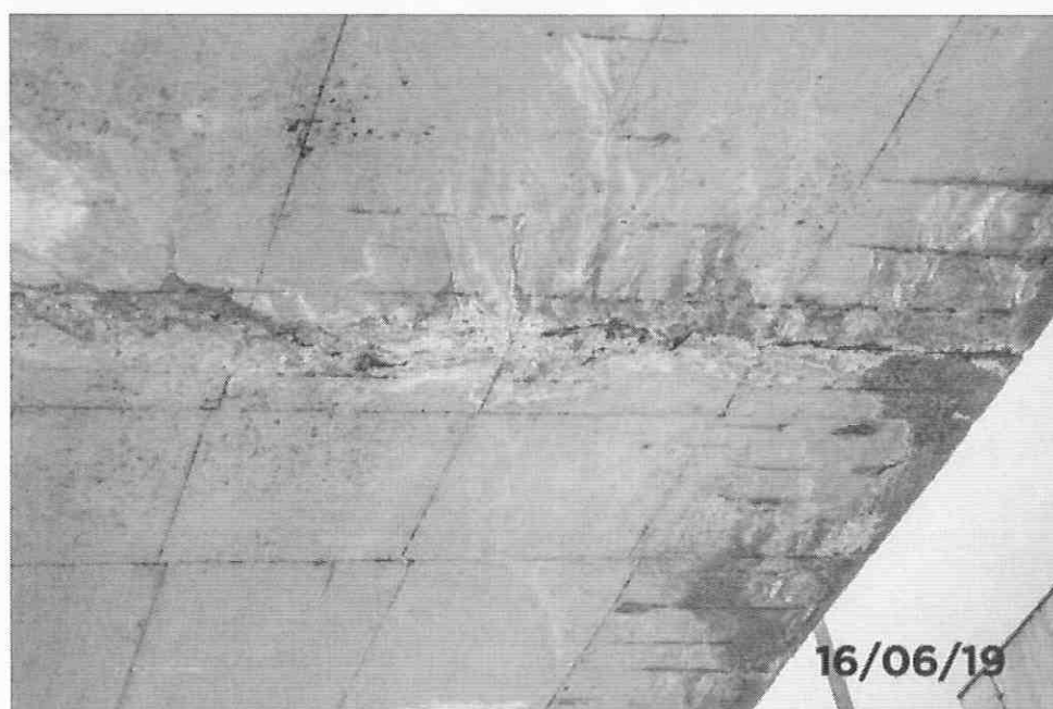
Foto 29- Detalhe na laje de trincas, eflorescência e armadura exposta.
