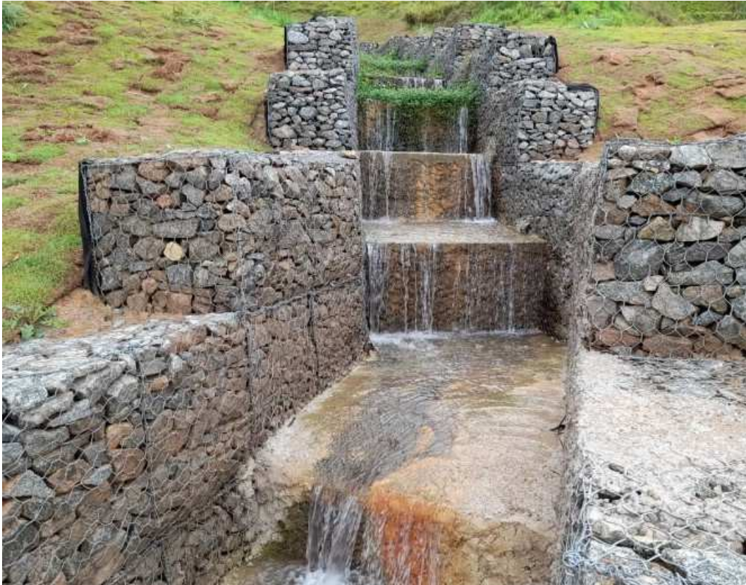
Figura 5 – Escada hidráulica - Fonte: Blog da Belgo Engenharia
