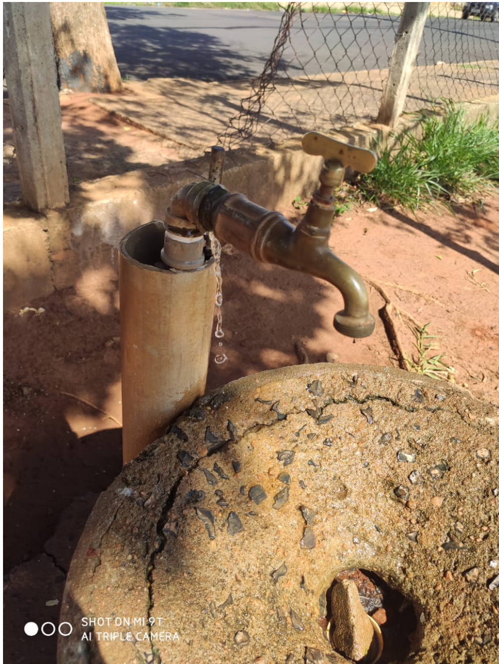
(Vazamento da água)
