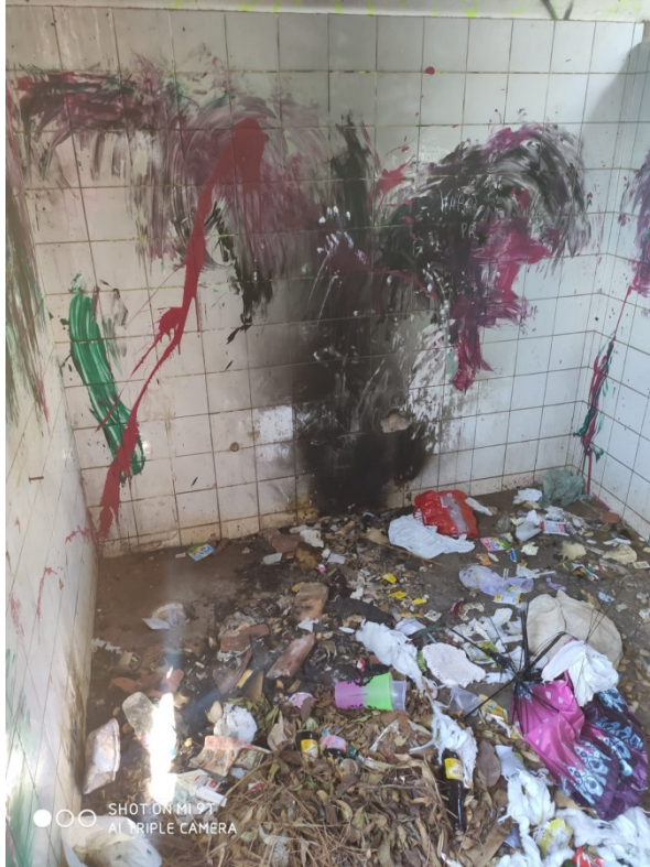
(Excesso de lixo no vestiário)
