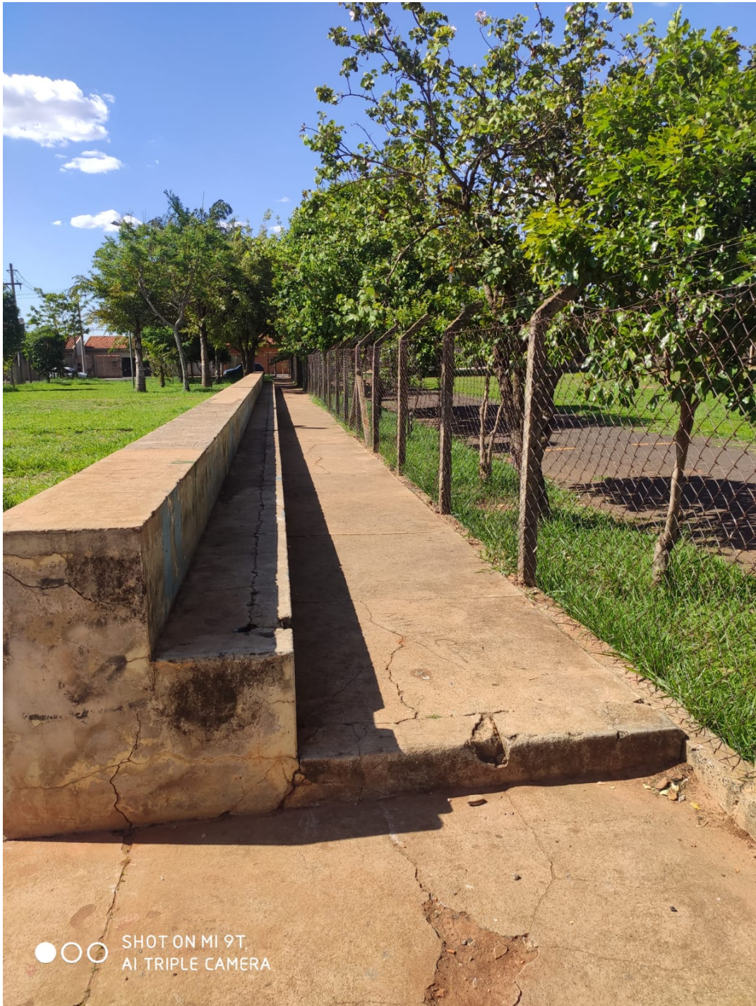
(Arquibancada com diversas rachaduras, e instalada atrás das grades e árvores)
