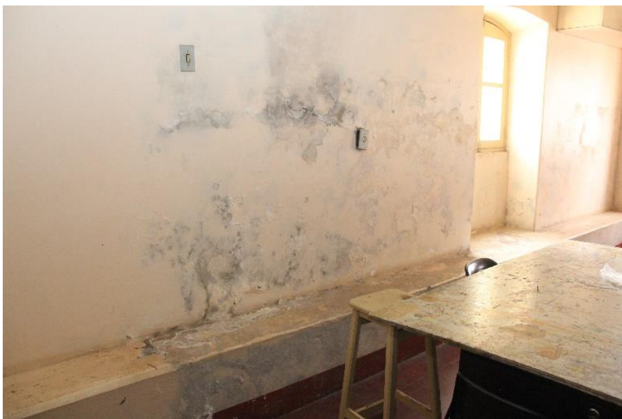
Foto 9 -Sala Térreo – P 2, onde ocorre as oficinas de arte (verifica-se a necessidade de impermeabilização nas paredes, revisão nas janelas, e pintura) Fonte: Alessandra de Lima, 2017.
