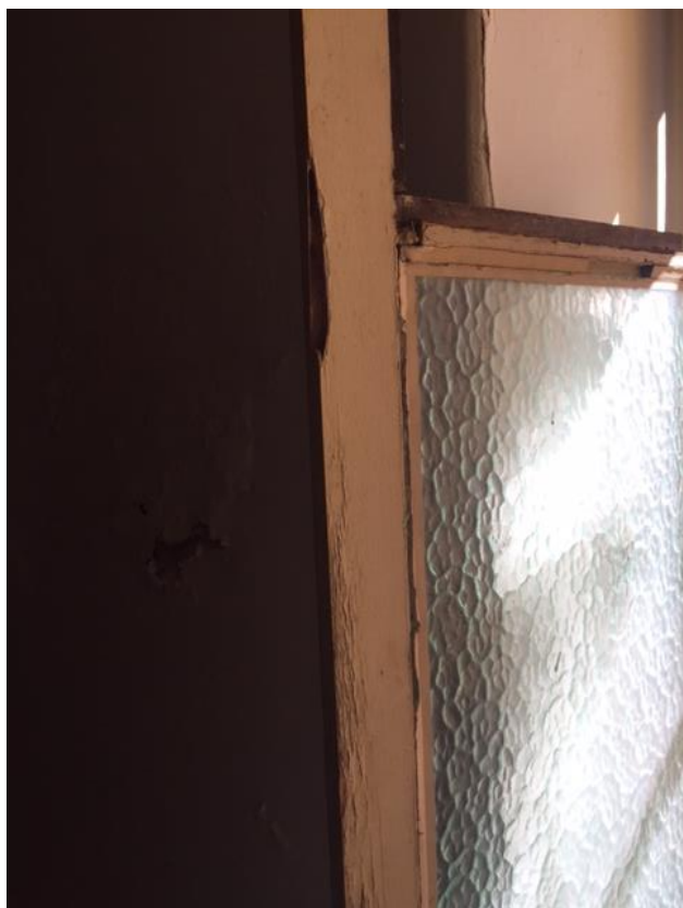
Foto 11 - de uma das janelas das salas para ilustrar as condições da maioria delas. Neste caso o vidro é martelado, o qual será repostado onde está faltante. Fonte: Alessandra de Lima, 2017.
