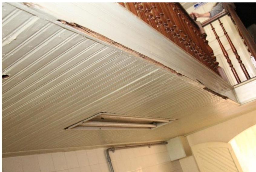
Foto 12 - do Forro do Térreo / embaixo piso 1º pavimento / escada: no Memorial Descritivo os forros serão retirados e colocados novos forros, no padrão madeira e dimensões, como os demais nas outras salas. Fonte: Alessandra de Lima, 2017.
