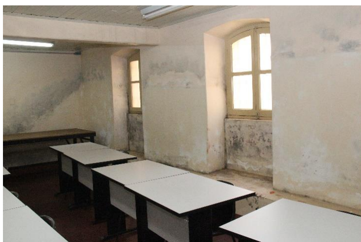
Foto 8 - Sala Térreo – P2, onde ocorre as oficinas de arte (verifica-se a necessidade de impermeabilização nas paredes, revisão nas janelas, e pintura)
