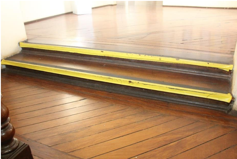
Foto 39 – Hall 2 - transição entre o 1º piso e 2º piso: piso de madeira: patamar da escada e mezanino. (Remoção do piso de madeira, reforçar os vigamentos de madeira e colocação de piso de madeira conforme Memorial Descritivo)
