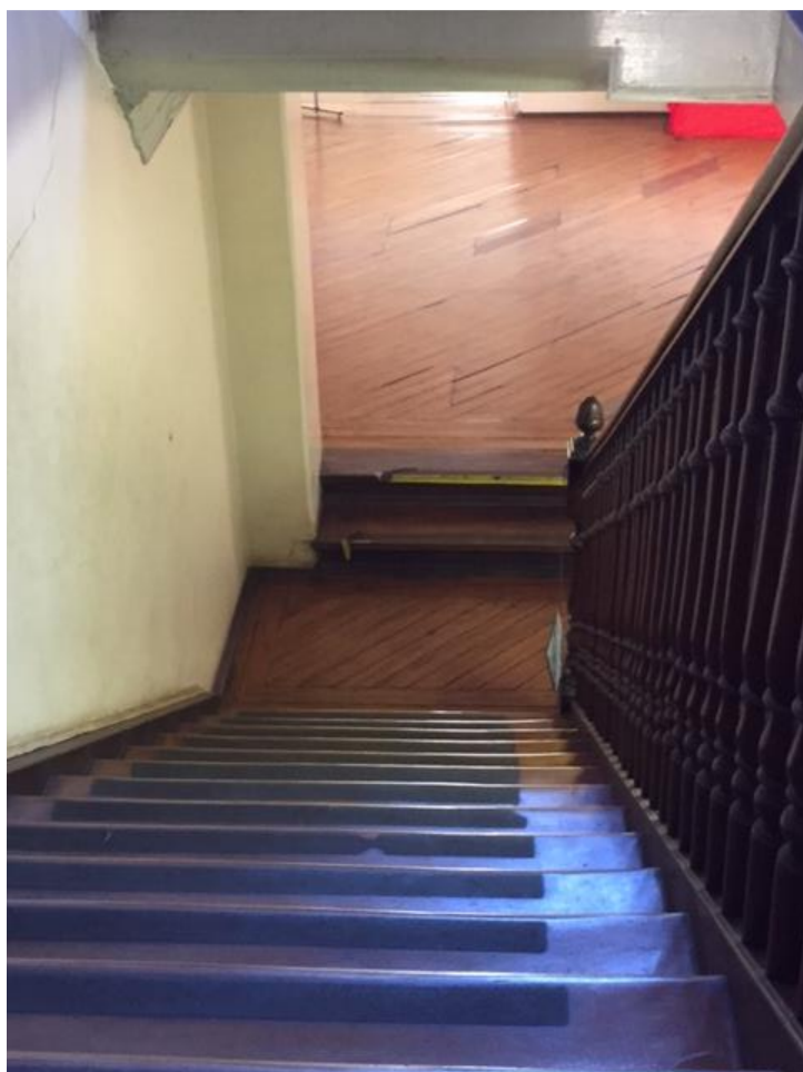
Foto 51 – Hall 2º pavimento – vista da escada. Escada deverá ser restabelecimento da cor do guarda-corpo e limpeza e Recuperação do piso.
