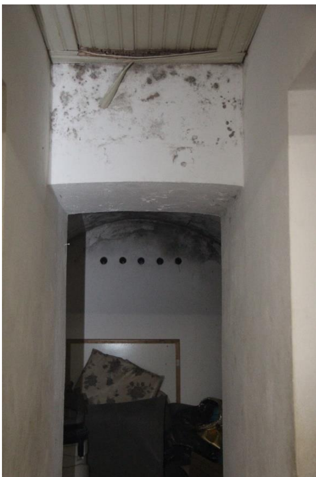
Foto 10- de sala no térreo - limpeza onde se verifica a mesma necessidade de limpeza, impermeabilização e pintura nas paredes, com esmalte a base de água. Fonte: Alessandra de Lima, 2017.
