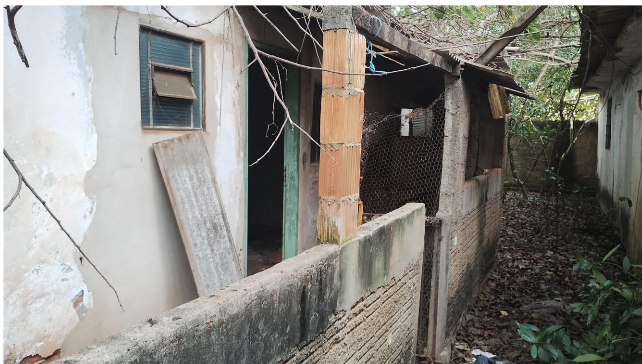
20. Foto 41: Desabamento parcial da varanda / lavanderia.
