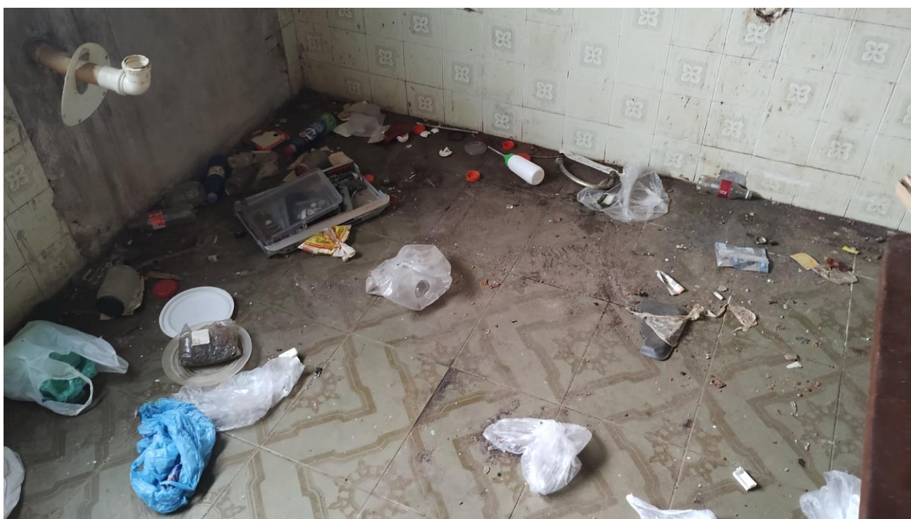
10. Fotos 19, 20 e 21: Presença de lixo e inservíveis no interior do prédio.
