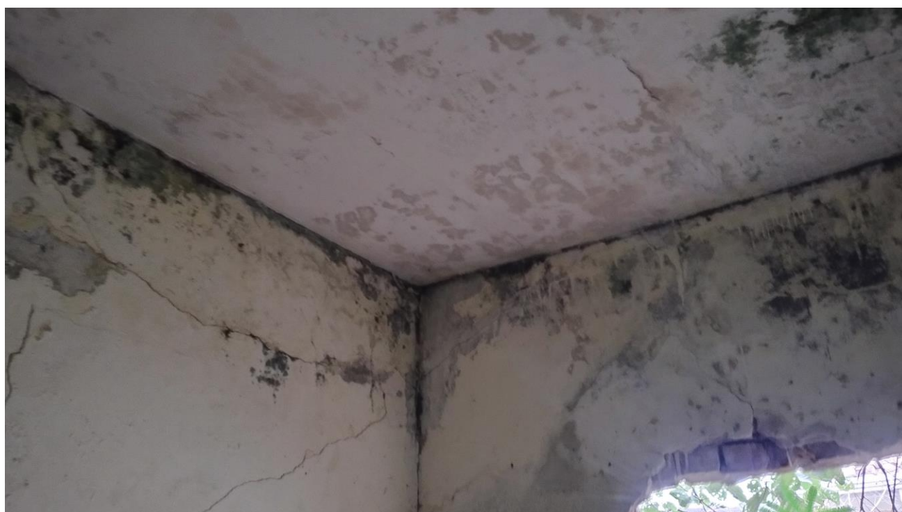
29. Foto 59: Janela arrancada e rachadura em parede do Dormitório.
