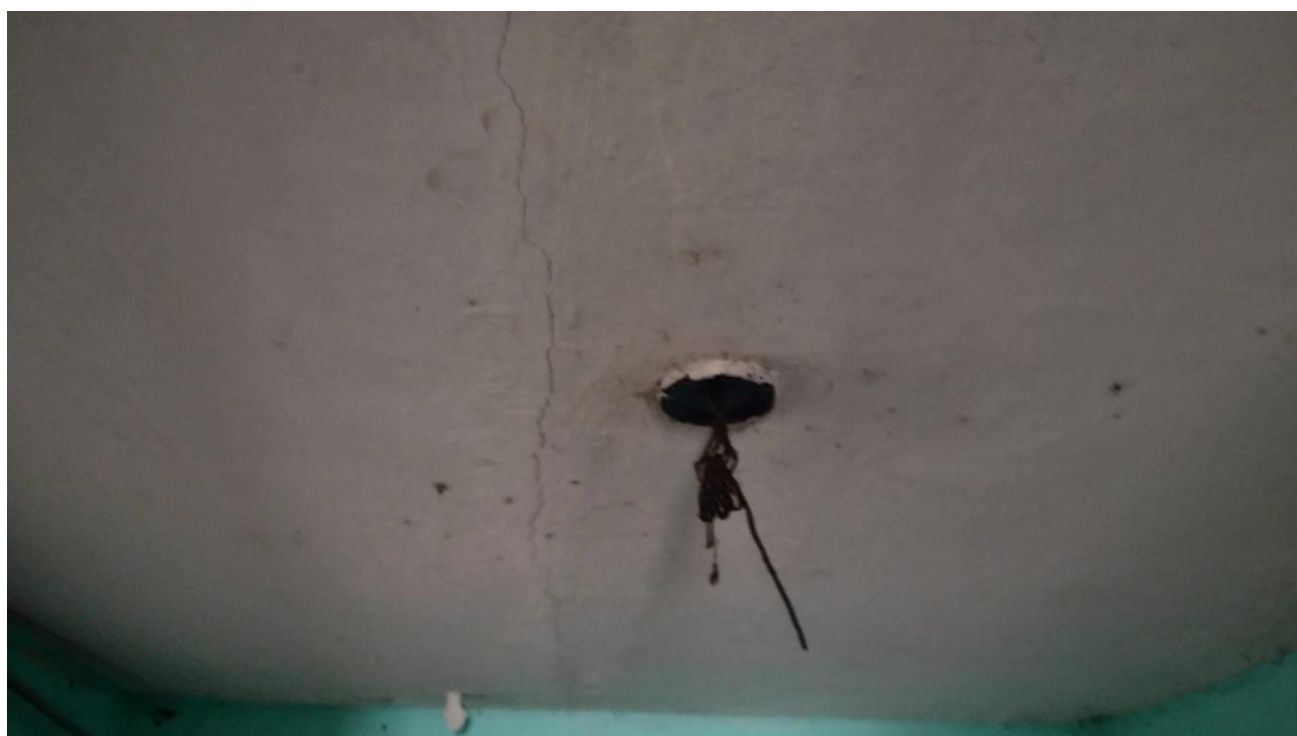
16. Foto 35: Rachadura na laje do Banheiro.
