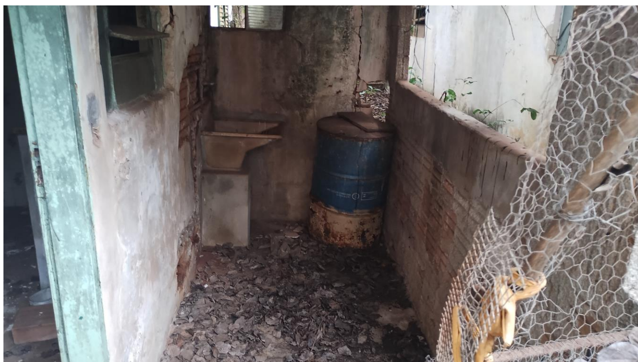
22. Fotos 43 e 44: Rachaduras e rompimento de alvenaria na Lavanderia.
