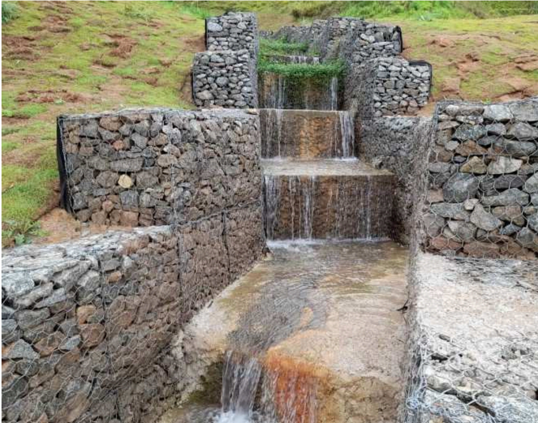
Figura 5 – Escada hidráulica - Fonte: Blog da Belgo Engenharia
