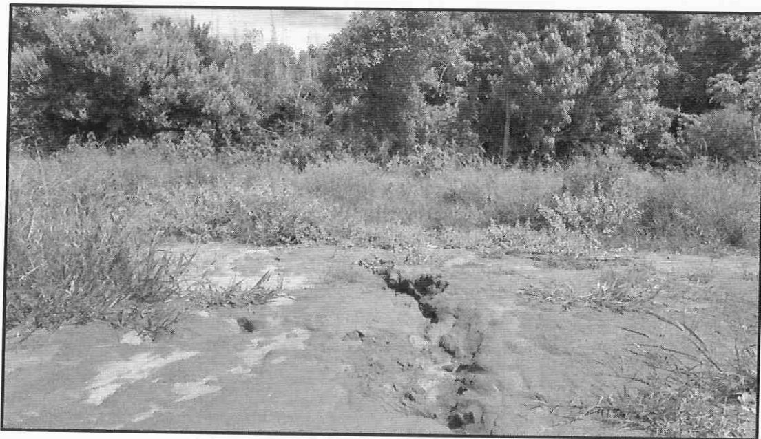
Ponto 6. Erosão pluvial
