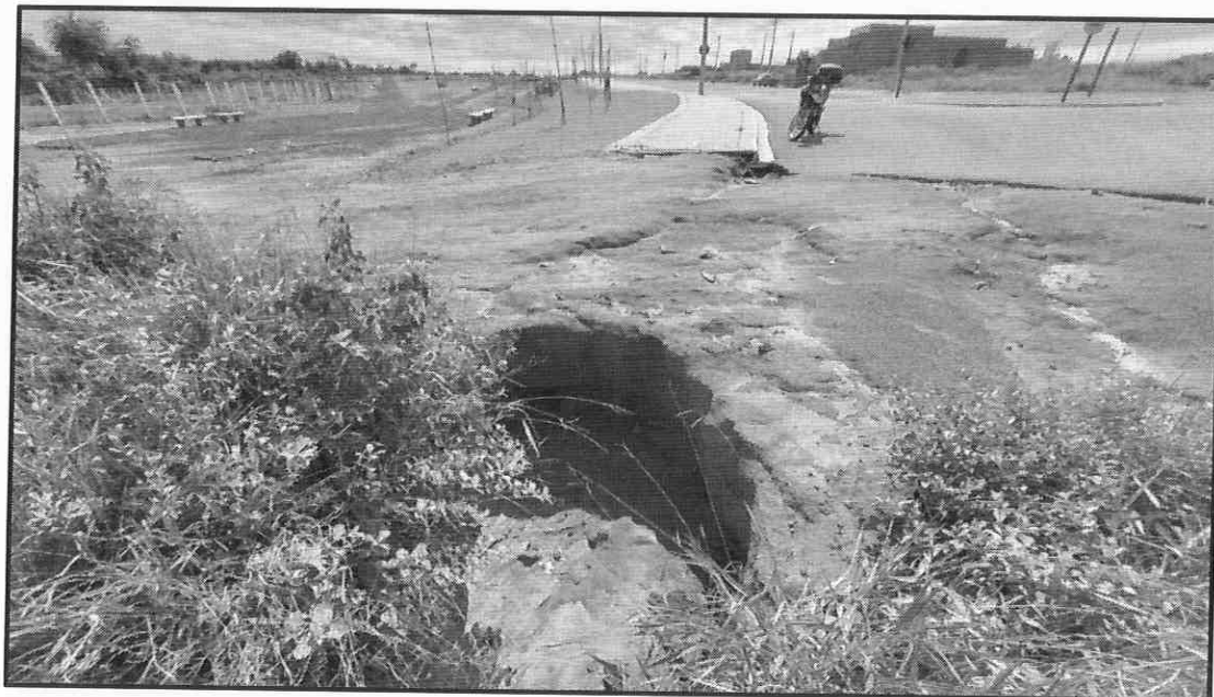
Ponto 2. Erosão pluvial localizada em porção de baixo relevo da microbacia
