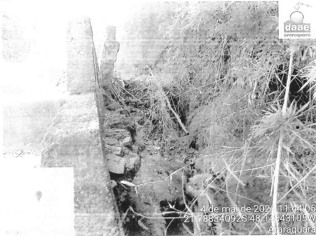
Foto 17: Erosão localizada a montante do sistema de lançamento de águas pluviais providas da av. Atilio Biscari. Indicação 06 da imagem 1 - I. C. 06.419.006
