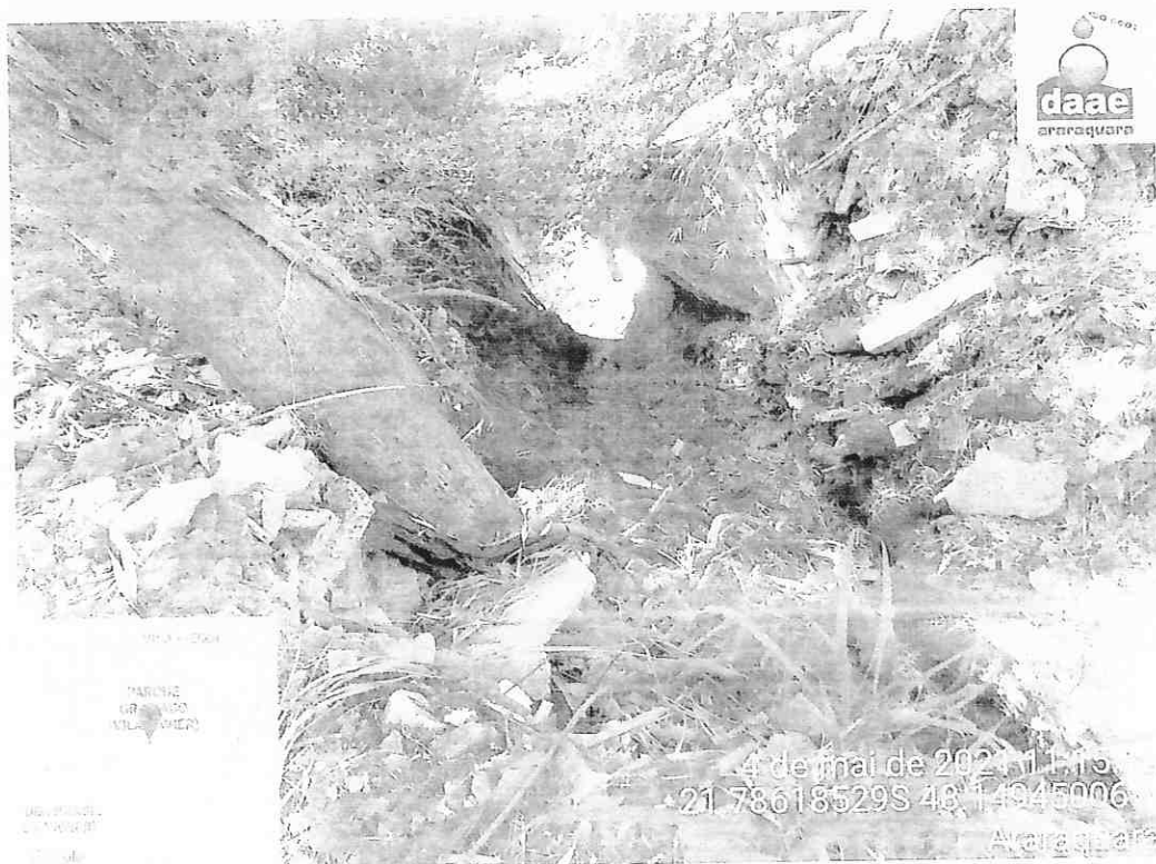
Foto 10: Erosão em área de preservação permanente. Indicação 03 Imagem 01 - I. C. 06.419.006
