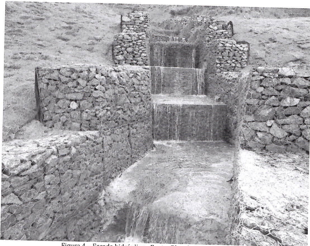
Figura 4 – Escada hidráulica - Fonte: Blog da Belgo Engenharia
