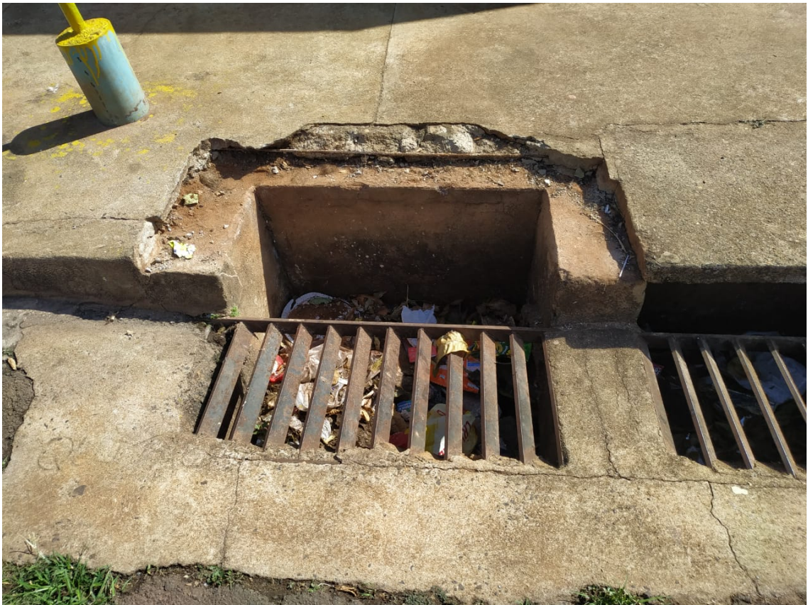
AVENIDA RONALD DE OLIVEIRA COSTA, PRÓXIMO AO Nº 6 – PARQUE DAS HORTÊNCIAS
