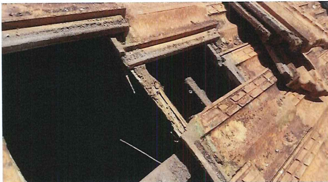
Foto 7 - Colapso do ripamento decorrente do ataque de cupins
