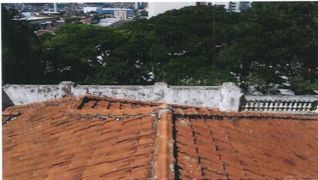
Foto 15: deteriorização do revestimento interno das platibandas
