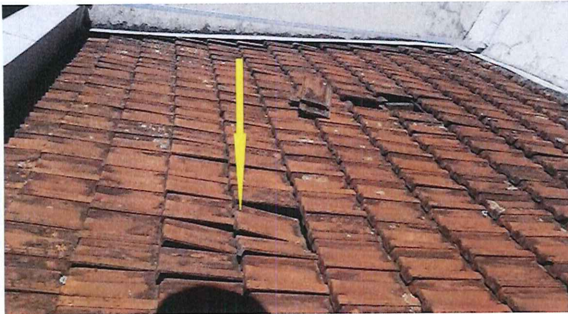
Foto 08: perda funcional do telhado por ruptura do ripamento
