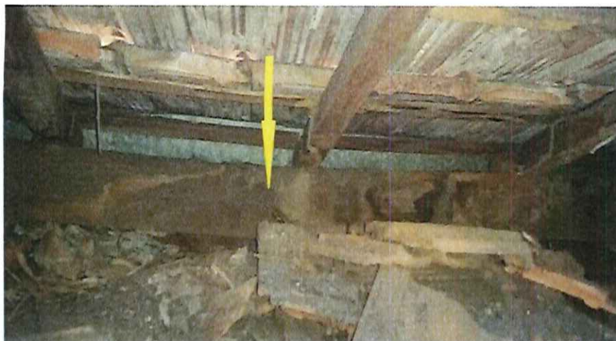
Foto 12: Deslocamento estrutural do madeiramento
