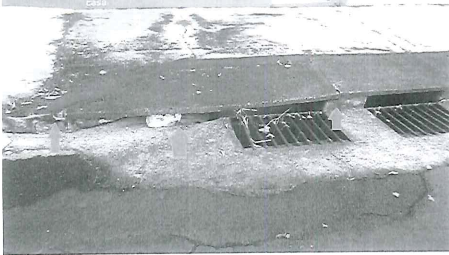
Bueiro c tampa e base quebrada na esquina de casa
