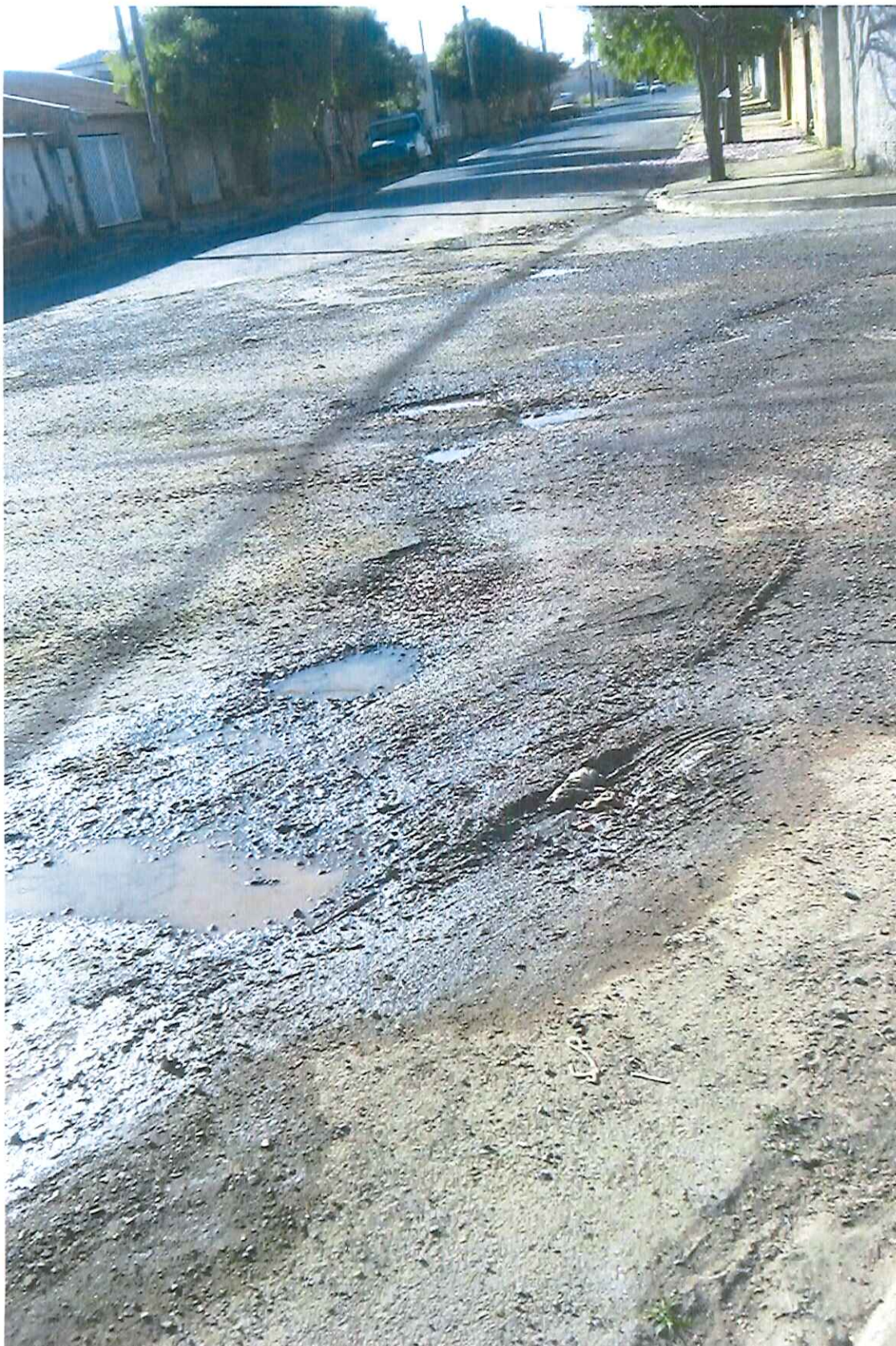
ANEXO 216 12072016 Tapar buracos na Avenida Eizo Kawakami com Ruas Lavíneo de Arruda Falcão e José Manoel de Mattos, Bairro Del Rey
